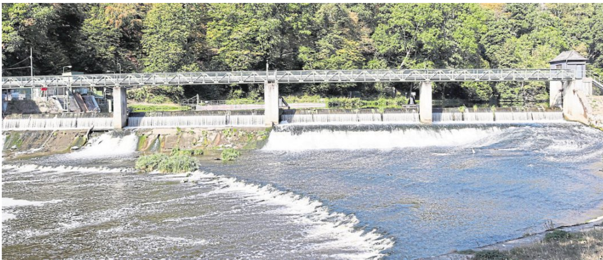
Die große Wehranlage Hollerich zwischen Obernhof und Nassau gehört zu jenen, die der Bund in den kommenden zehn Jahren an der Lahn durch Neubauten ersetzen will. Foto: Carlo Rosenkranz
