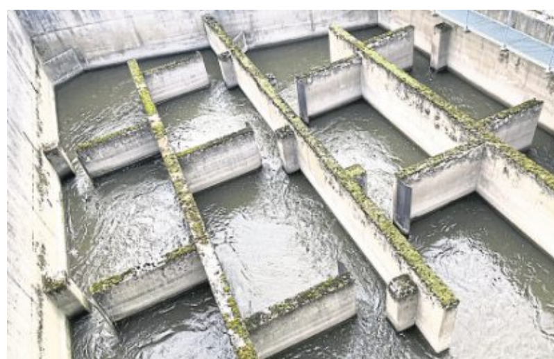
In Nassau ist bereits seit 2005 ein Fischaufstieg neben der Wehranlage in Betrieb. Auch die übrigen Standorte werden aufgerüstet. Foto: Rosenkranz
